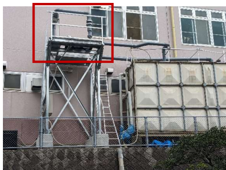
UFB発生装置（左）及び受水槽（右）
