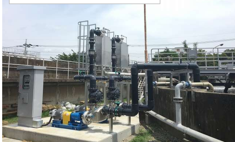
UFB発生装置とポンプ、制御盤
