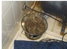
配管内の汚れ
