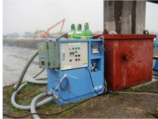
左：UFB発生装置 右：廃液タンク
