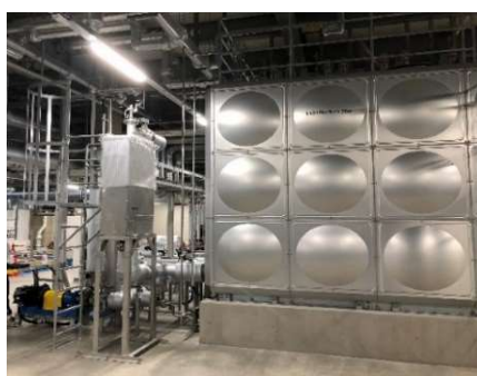
左：UFB発生装置 右：熱水タンク
